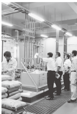
薬品注入装置を点検中
